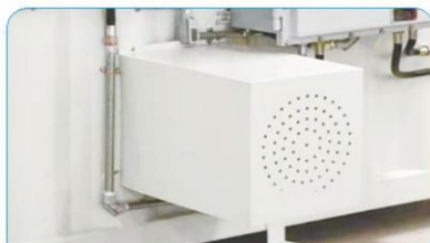
防爆排风系统
