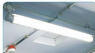
防爆照明系统
